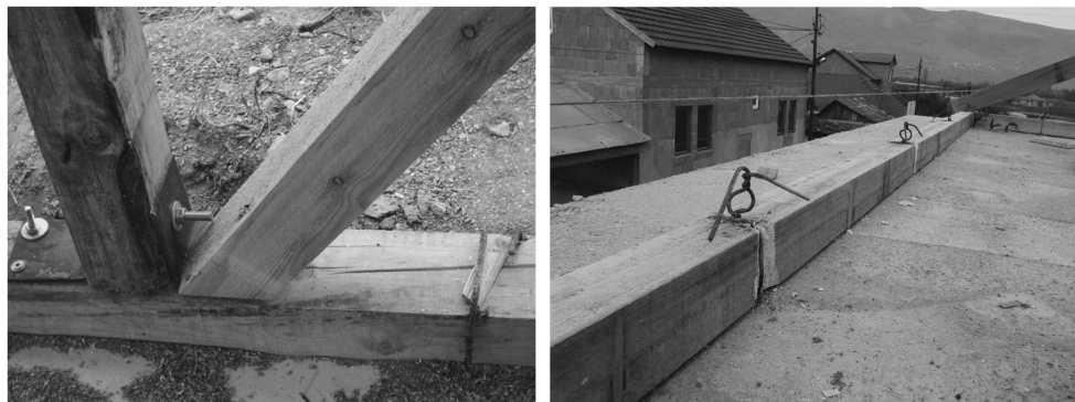
Slika 2. Neadekvatno ankerisanje pomoću armaturnih“brkova” i oštećenje vjenčanice
