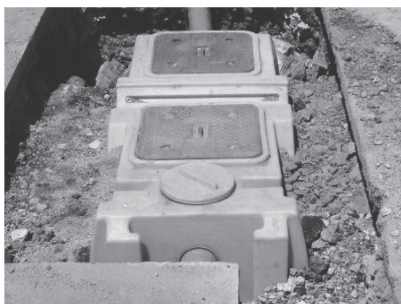
Slika 3. Izgled separatora ulja i naftnih derivata (ugradnja u zemlju)
